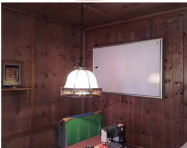
Ein 300 Jahre altes Haus in Biberwier wurde für zehn Kriegsflüchtlinge aus Armenien, Syrien, Irak und dem Kongo mit easyTherm-Infrarotheizungspaneelen bewohnbar gemacht.
