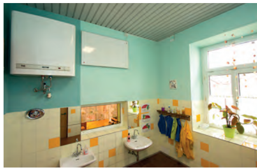
Ähnlich wie in den anderen Räumen des Kindergartens wurden die Heizpaneele so positioniert, dass sie nicht in Reichweite der Kinder sind. Ein weiterer Vorteil: Die Mauern sind heute wesentlich trockener als vor der Installation der Infrarotheizung.
