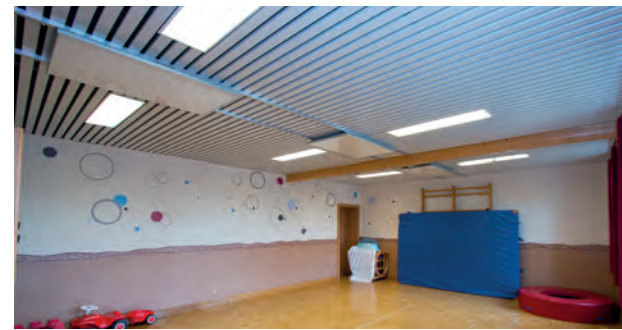
Eine besondere Herausforderung – im Turnsaal müssen die Heizpaneele an der Decke des Raumes nicht nur für Wärme sorgen, sondern auch stabil genug sein, um den Umgebungsbedingungen gerecht zu werden.
