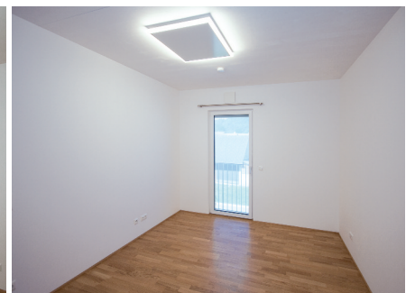
Die Heizpaneele von easyTherm an der Decke jedes Raumes wurden mit LED-Lichtbändern ergänzt und erfüllen somit auch die Aufgabe der Grundbeleuchtung.
