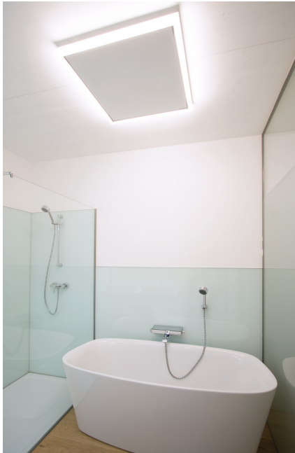
In den modern eingerichteten Badezimmern darf die Infrartheizung aus dem Hause easy-Therm nicht fehlen – die Steuerung der Paneele ist Teil des KNX-Systems.
